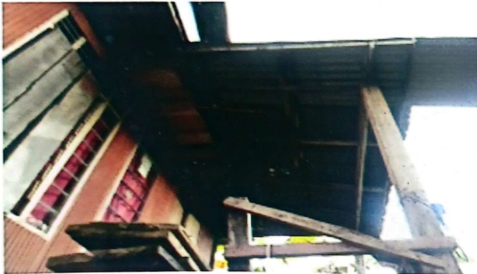
DOKUMENTASI RUMAH LUNAWATI SEBELUM DIBEDAH RUMAH
